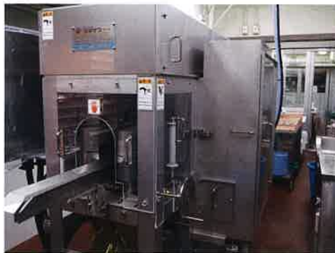
第2加工室に設置されているフィレマシン。ウロコ取り機や真空包装機などと組み合わせることで、マダイの皮付きフィレなら、100尾分を約20分間で製造できるといふ。
